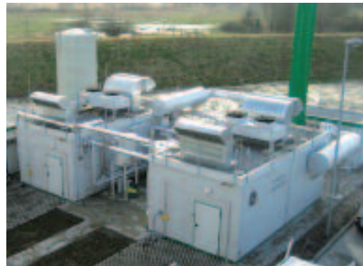
Biomasse-KWK (Kraft-Wärme- Kopplung) Anlage Rostock
